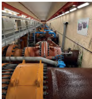
Steuerventile zu den Turbinen
